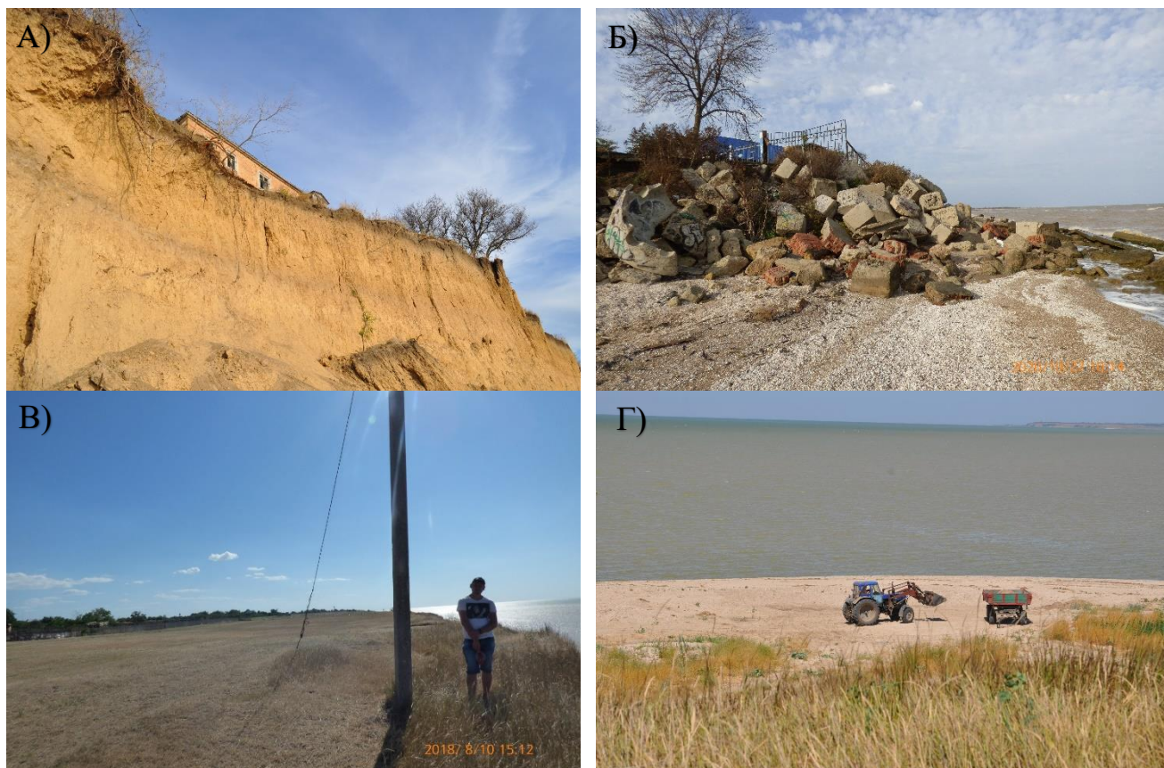
Рисунок 1.21 — Примеры проявления антропогенных факторов в береговой зоне Таганрогского залива (составлено автором, фото автора): А) – Капитальная постройка на абразионном берегу (с. Весело-Вознесенка, Рост. Обл.); Б) – Нерациональная берегозащита (ст. Должанская, Краснодарский край.); В) – Распашка под обрыв (с. Шабельское, Краснодарский край.); Г) – Изъятие пляжевого материала (с. Порт-Катон Должанская, Ростовская область)
